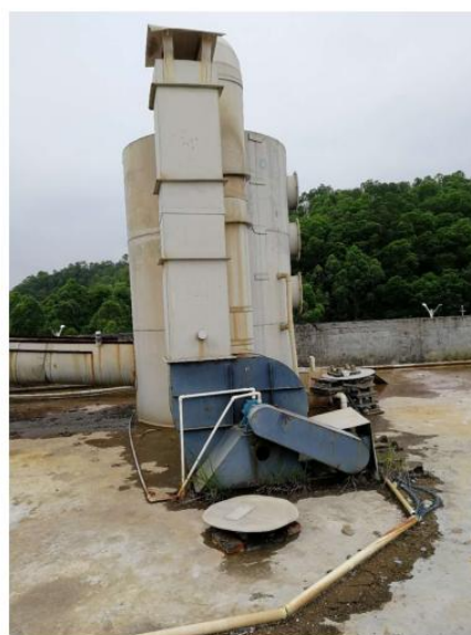
喷油废气处理设施
